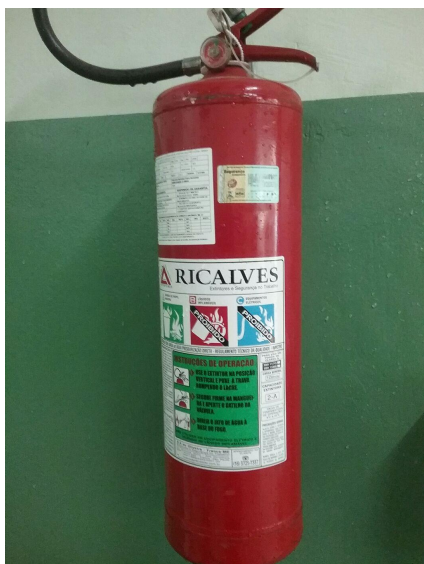
extintor de incêndio
