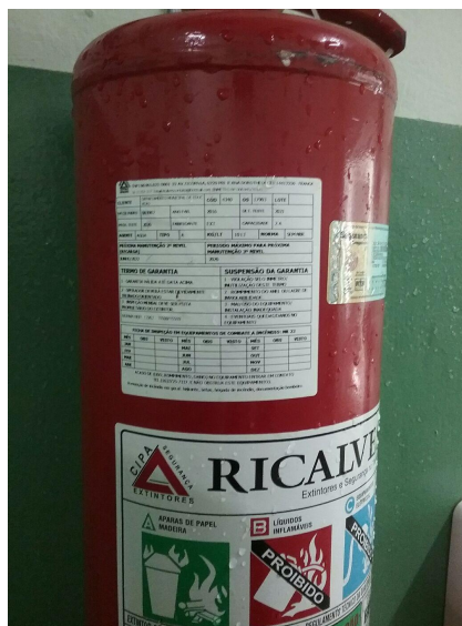
extintor de incêndio
