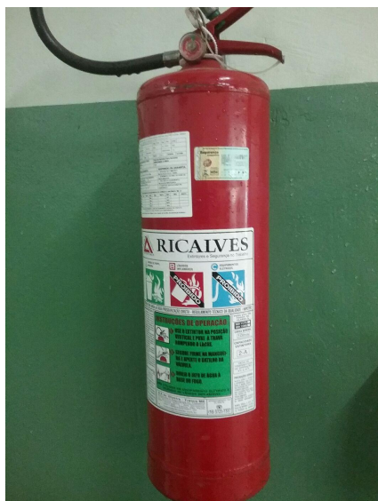
extintor de incêndio
