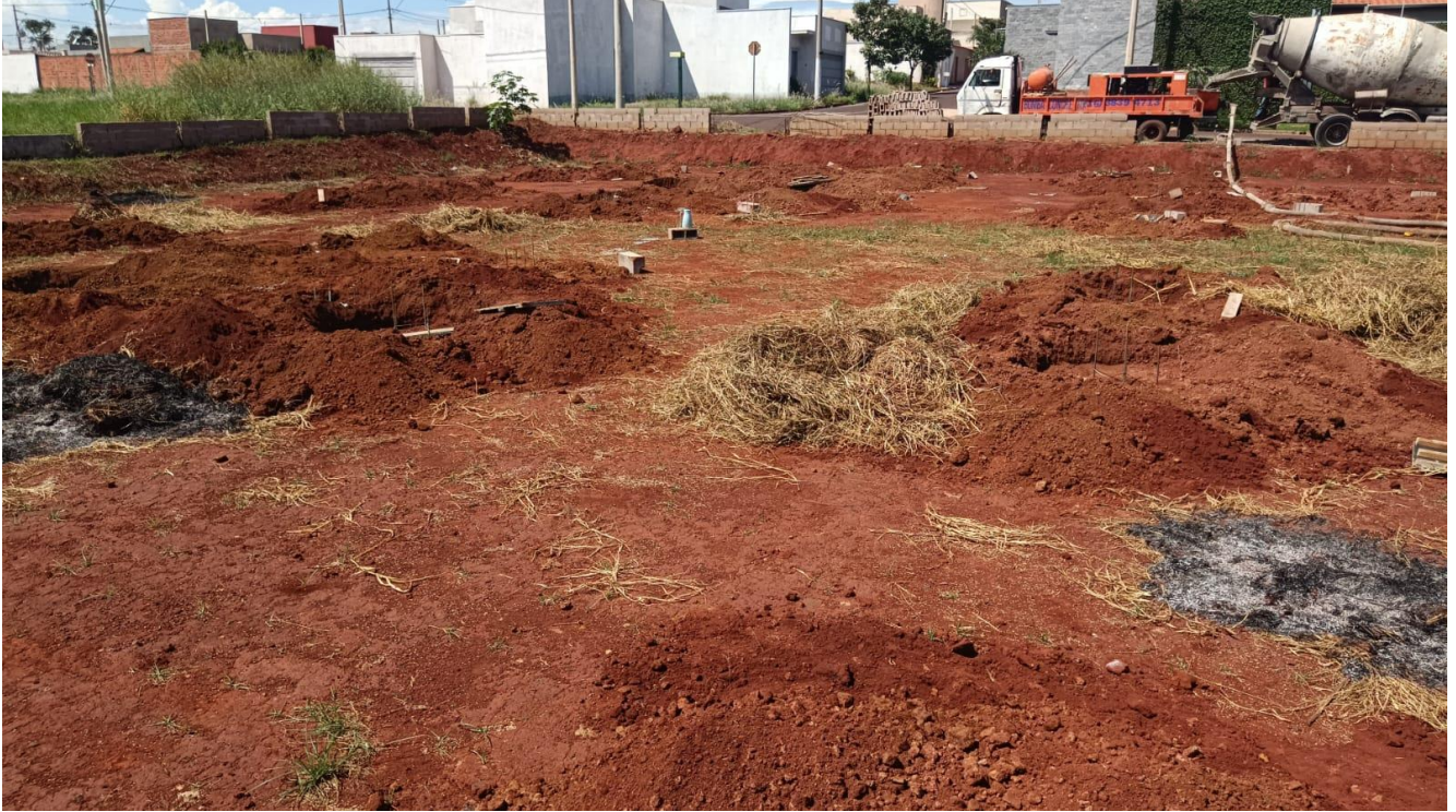
Foto 05 - Referente aos serviços de concretagem das estacas armadas escavadas com profundidades variando entre 7,5 metros e 13 metros de profundidade, com diâmetros variando de 0,30 m a 0,50 m.
