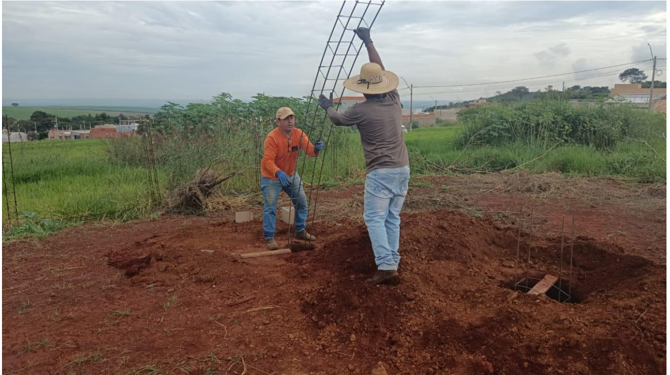
Foto 06 - Referente aos serviços de concretagem das estacas armadas escavadas com profundidades variando entre 7,5 metros e 13 metros de profundidade, com diâmetros variando de 0,30 m a 0,50 m.
